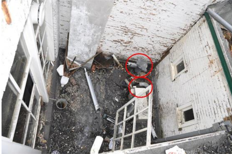
Foto 27, bovenste cirkel doorvoer metalen kanaal, onderste PVC doorvoer airco.
