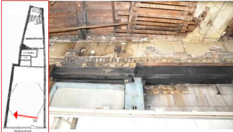
Foto 12, beroete stalen lateien ter plaatse van doorgang voorzijde kapsalon (Kelders 33)
