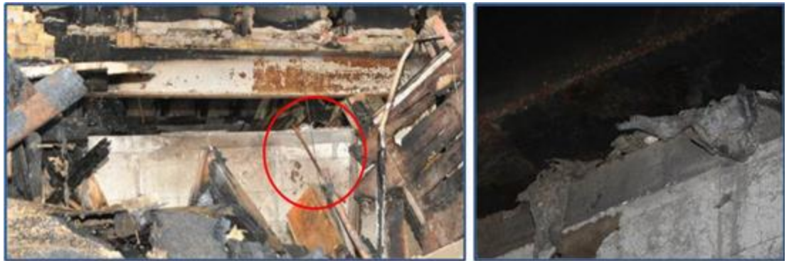
foto 7 & 8, links leiding over scheidingswand, rechts restanten glaswol op scheidingsconstructie.
