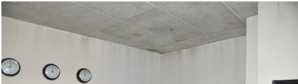
Foto 23, verlaagd plafond appartement nr. 38b, sporen rookverspreiding bij plafond.
