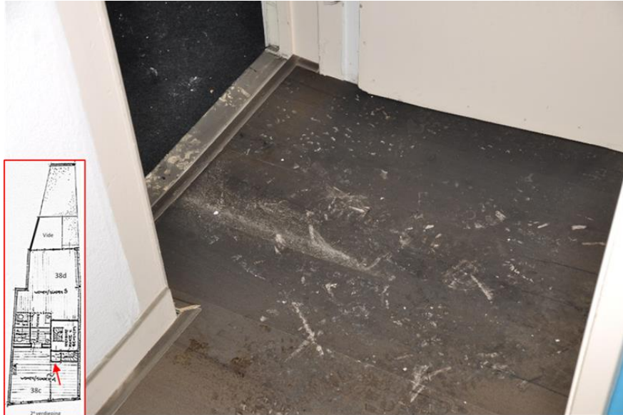
Foto 25, rookverspreiding onder deur bij appartement nr. 38c.
