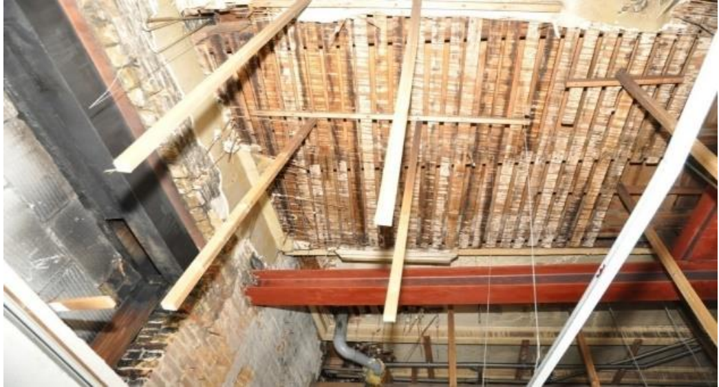
Foto 17, houten latten stuc op riet, staalconstructie, achterin stuc op riet.
