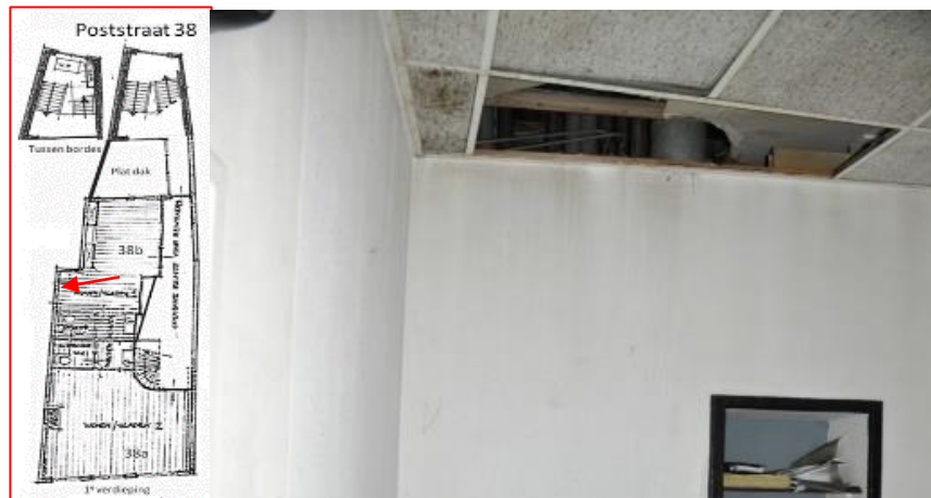
Foto 24, schacht boven plafond (circa 50 cm diep) in open verbinding met kapsalon.
