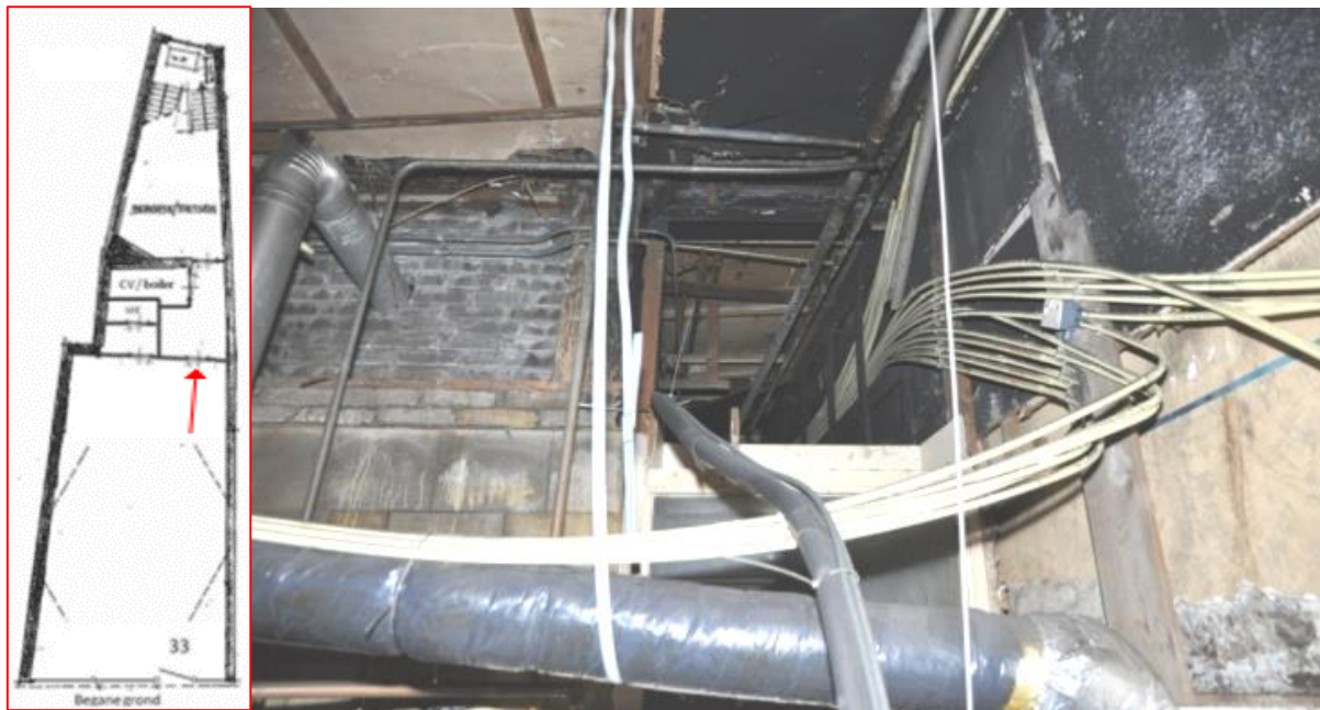
Foto 19, open verbinding boven verlaagd plafond tussen kapsalon en bergruimte.
